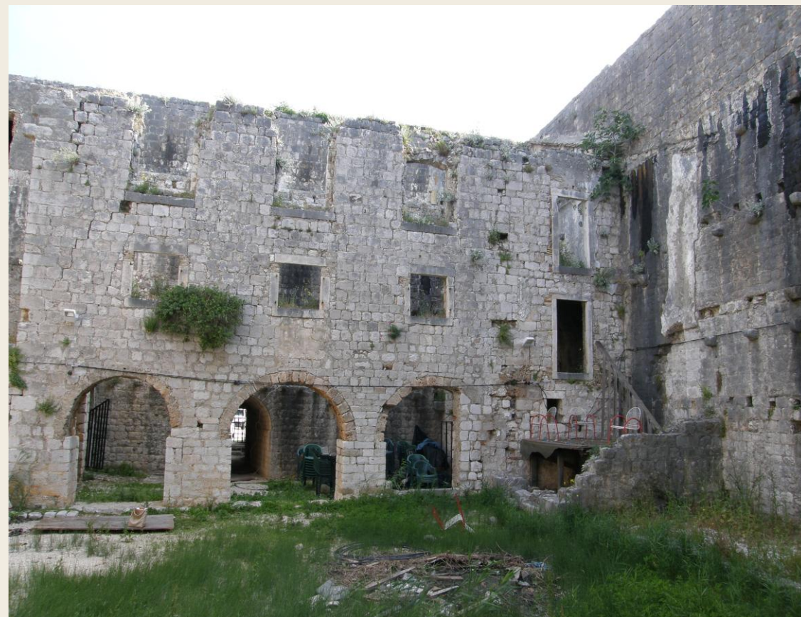
Dvorište kaštelanove kuće prije sanacije
